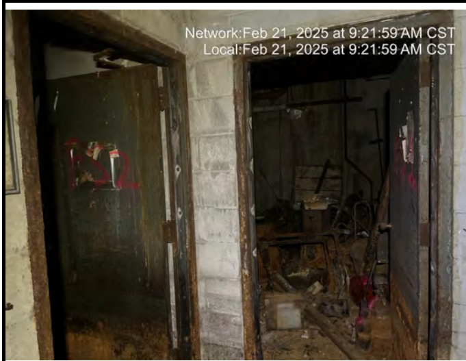
Assumed Material # A-3 Fire Door - Metal
