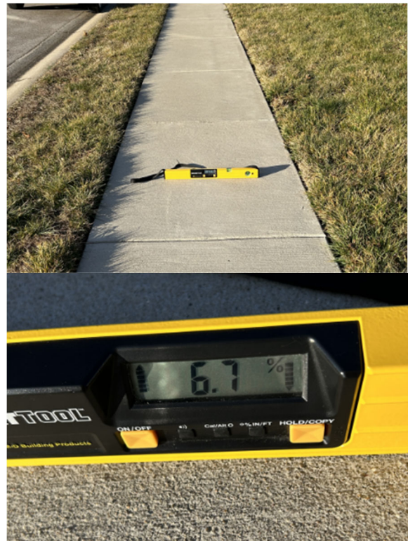
Example PAR with excessive cross slope
