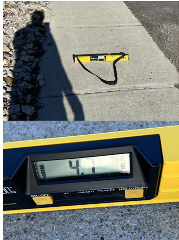
Example PAR with excessive cross slope
