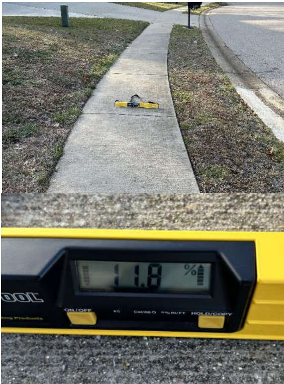
Example PAR with excessive cross slope
